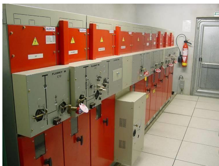
Intérieur d'un poste de livraison
