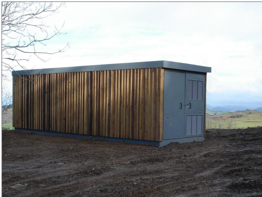
Exemple d'un poste de livraison implanté sur un site éolien
