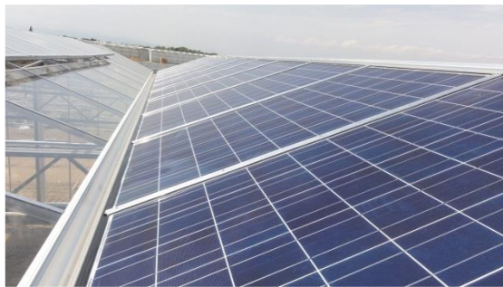
Serres photovoltaïque SAINT LAURENT D'AIGOUZE (30) Puissance électrique : 4.4 MWc Mise en service : Février 2012
